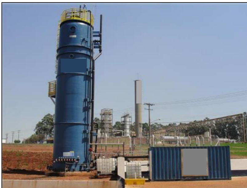
Figura 3.4 - Foto do biodigestor piloto implantando Fonte: Autor, 2017
